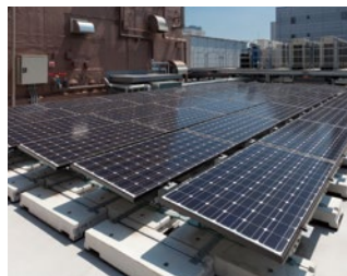
太陽光パネル
