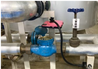
メーター監視カメラ
