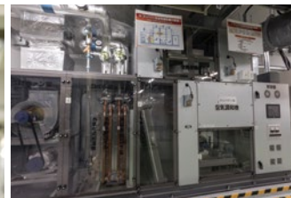
空調設備点検
