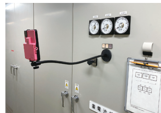
メーター監視カメラ
